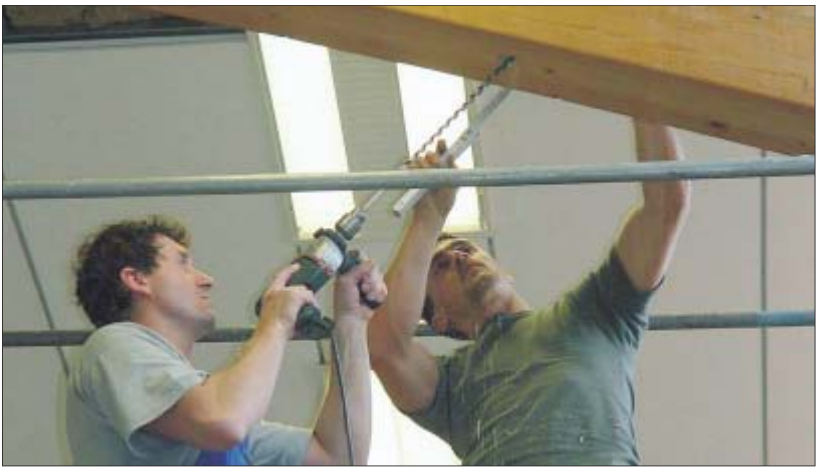
Quersugsicherungen mit Gewindestangen sorgen für zusätzliche Stabilität.
